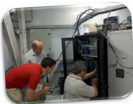
Vista del interior en la caseta superior de la torre del RMA1, a 33m de altura. Sitio de la UNC, Córdoba (mayo 2015).
